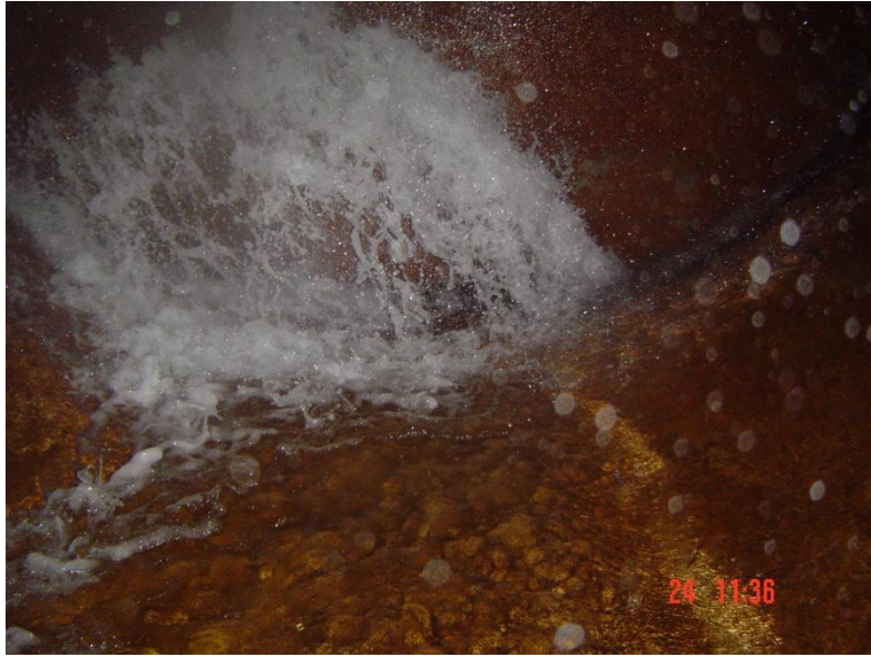
Şekil 1. Cebri boru giriş kapağı kaçak suyu
