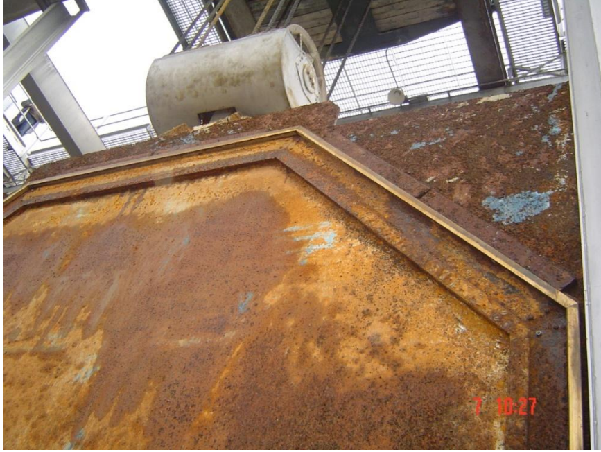
Şekil 3. Cebri boru giriş kapağı üzerindeki pirinç contalar
