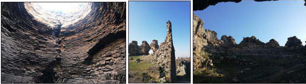
Şekil 2. Sur duvarları ve burç içlerindeki taş-tuğla malzeme kayıpları
