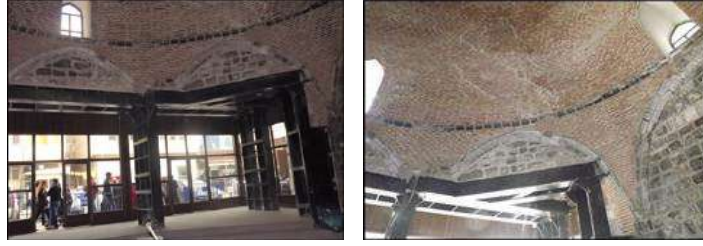
Şekil 5. Vahap Ağa Hamamı'ndaki kubbede oluşan çatlak hasarları (Kasım 2018)
