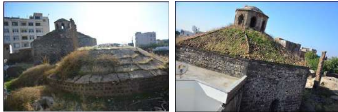
Şekil 6. Deva Hamamında doğa koşullarına bağlı oluşan bitkilenme hasarları (Aralık 2019)
