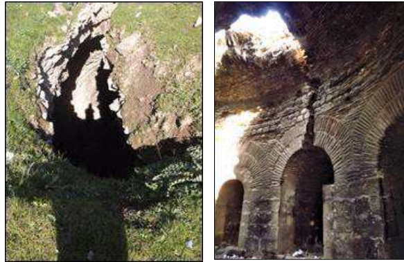
Şekil 4. Burç kubbelerindeki çatlak ve yıkılma hasarları (Aralık 2019)
