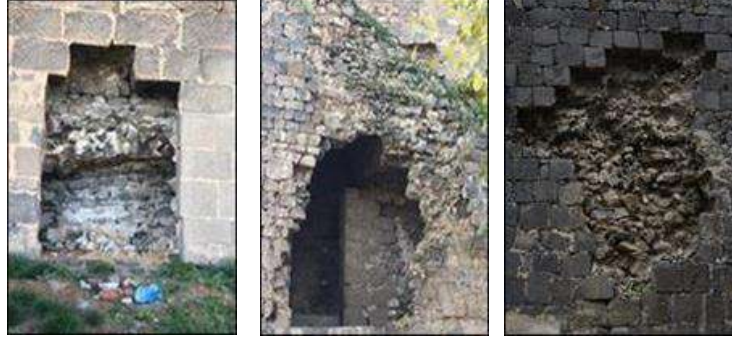
Şekil 6. numaralı burçlardaki derz boşalmaları ve malzeme kayıpları (Aralık 2019)
