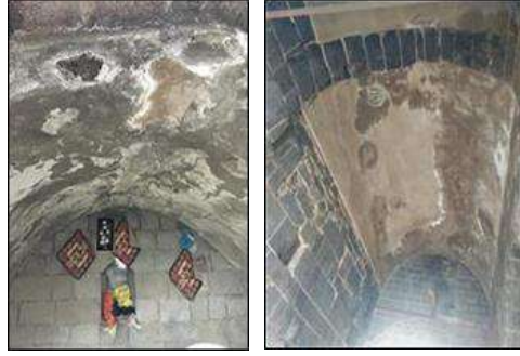
Şekil 8. Sur duvarları ve burçlarda oluşan nem hasarları (Aralık 2019)
