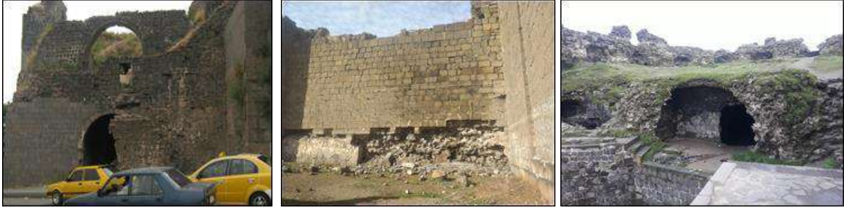
Şekil 11. Burçlarda doğa koşulları ve bakımsızlık nedeniyle oluşan hasarlar (Aralık 2019)
