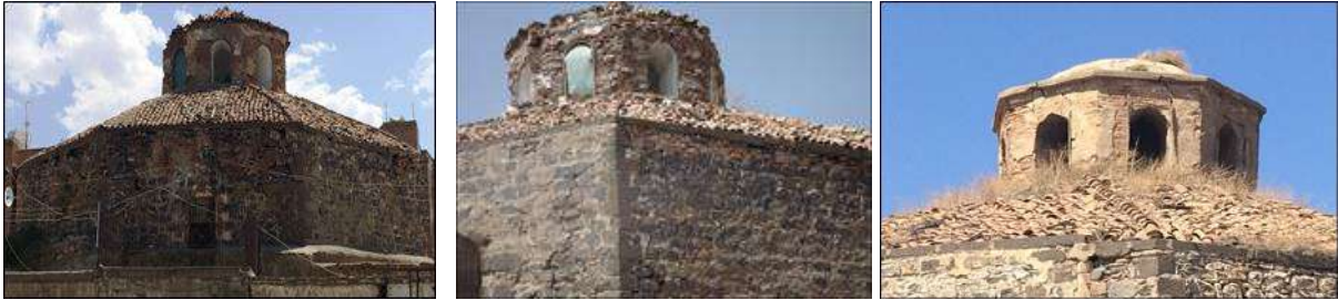
Şekil 4. Melik Ahmet Paşa ile Deva Hamamı fener ve duvarlarındaki ayrışma ve çözülme hasarları (Aralık 2019)
