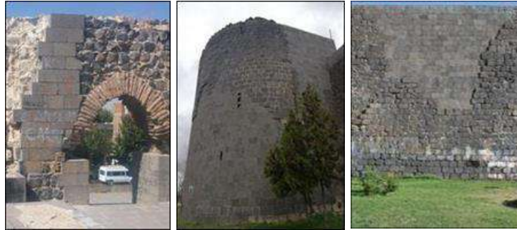
Şekil 9. Burçlardaki hatalı restorasyon uygulamaları (Aralık 2019)
