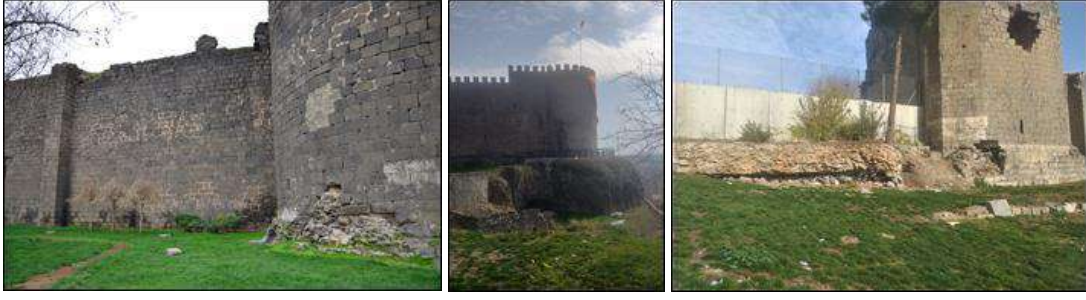
Şekil 10. Sur diplerindeki peysaj düzenlemelerine bağlı nemlenme hasarları (Aralık 2019)
