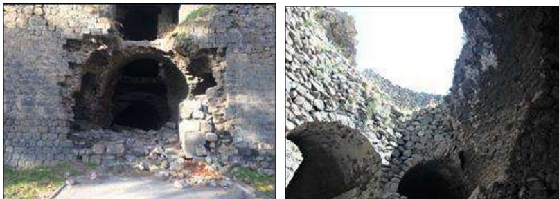
Şekil 5. Burç döşemelerinde oturma, çökme hasarları (Aralık 2019)
