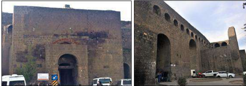
Şekil 7. Urfa Kapı ve 57-58 burç arasındaki sur duvarındaki ayrışma ve aks kayma hasarları (Aralık 2019)
