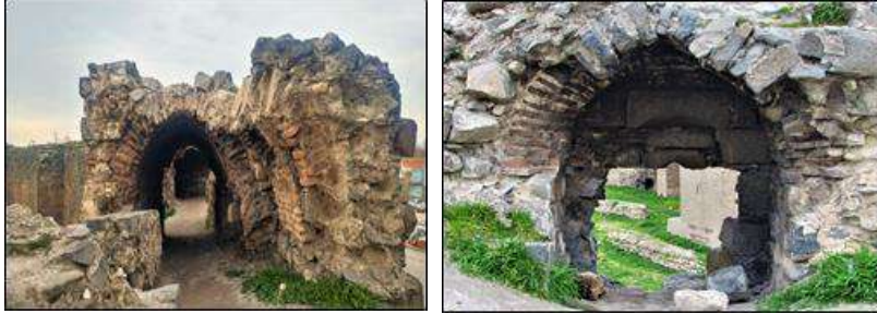
Şekil 3. Burçlardaki kemer ve örgü elemanlarında çatlak malzeme kaybı ve ayrışma hasarları (Aralık 2019)
