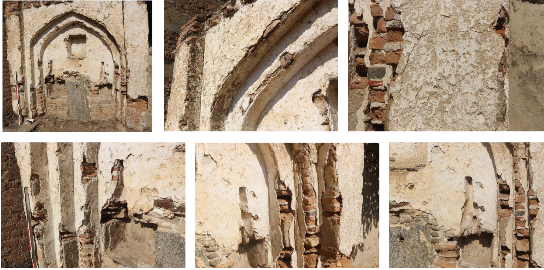
Görsel 6. Harç ve Sıva Bozulmalarından Detay Görünümler.
