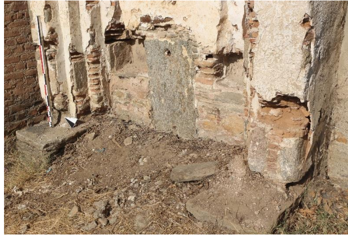
Görsel 5. Taş Malzemede Görülen Bozulmalar.
