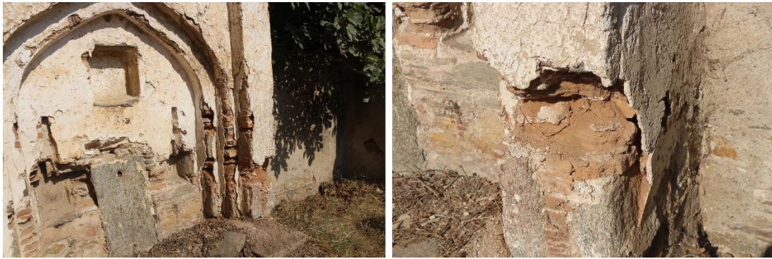
Görsel 7. Tuğla Malzemedeki Bozulma Detayları.
