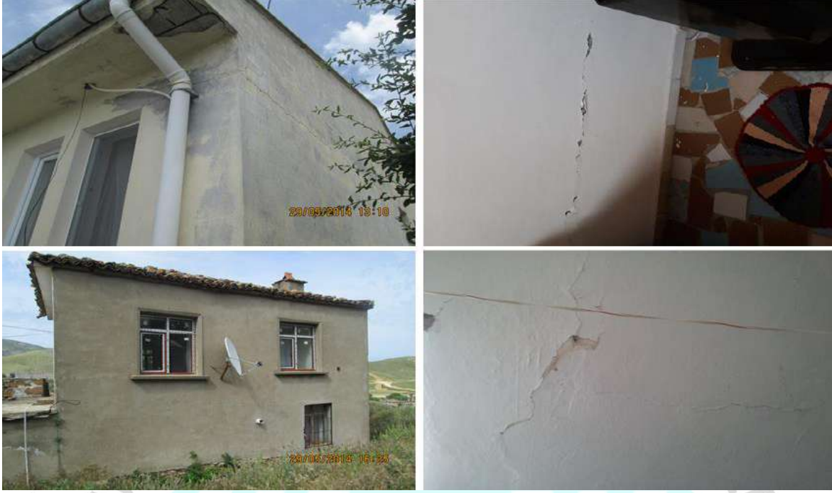
Şekil 6. Yapısal olmayan elemanlarda gözlemlenen hasarlar
