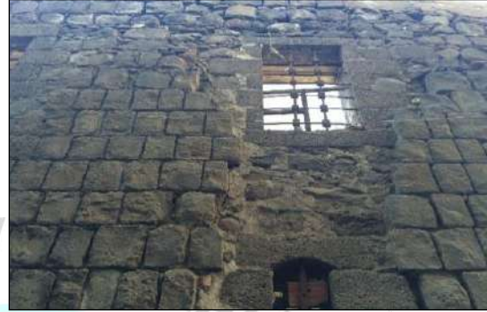
Şekil 12. Çifte Han Doğu Duvarında Oluşan Ayrışma, Çözülme Hasarı 2019
