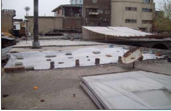
Şekil 23. Sülüklü Han'da Hatalı Restorasyonla Değiştirilen Üst Örtü Hasarı
