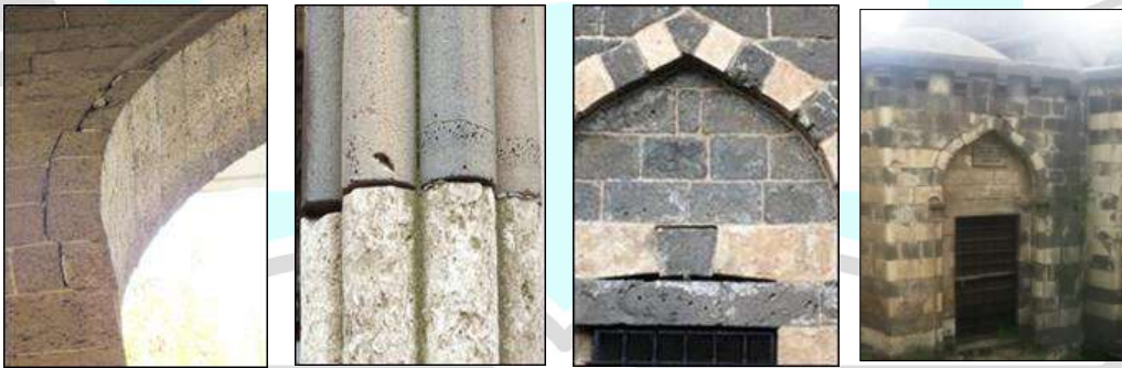
Şekil 21. Camilerdeki Harçların Boşalması ve Yok Olmasına Bağlı Oluşan Hasarlar
