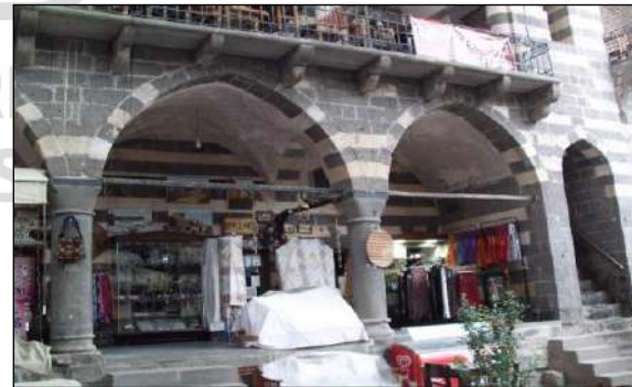
Şekil 14. Hasan Paşa Hanı Revak Kemerlerindeki Ayrışma Hasarı 2019
