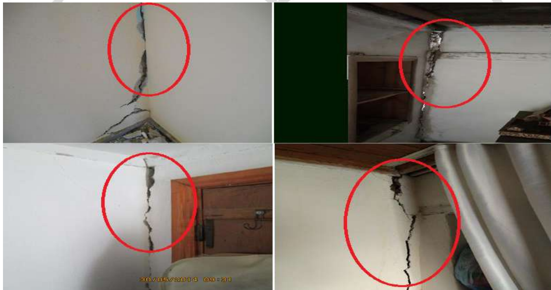
Şekil 4. Duvar köşe noktalarında gözlemlenen ayrışma hasarları
