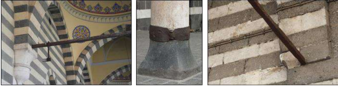
Şekil 20. İskender Paşa ve Behram Paşa Camilerinde Gergi Çubuk ilke Bileziklerindeki Korozyon Hasarı
