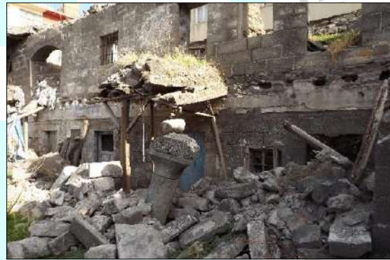
Şekil 28. Çifte Han Güney Cephesinde Doğa Koşulları ve Bakımsızlığa Bağlı Oluşan Hasar
