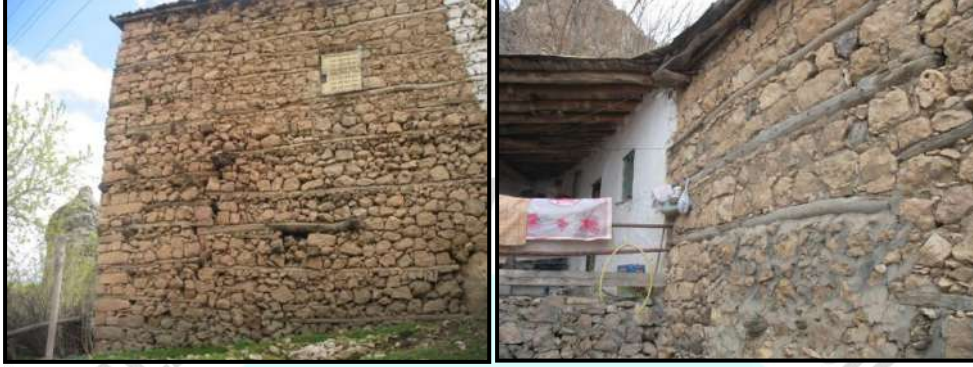
Şekil.2.2 Duvar örgüsünde ahşap hatıl kullanım örnekleri
