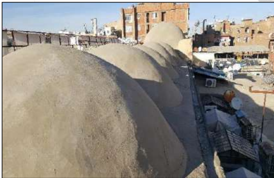
Şekil 13. Hasan Paşa Hanı Üst Örtü ve Kubbelerindeki Kılcal Çatlak Hasarı
