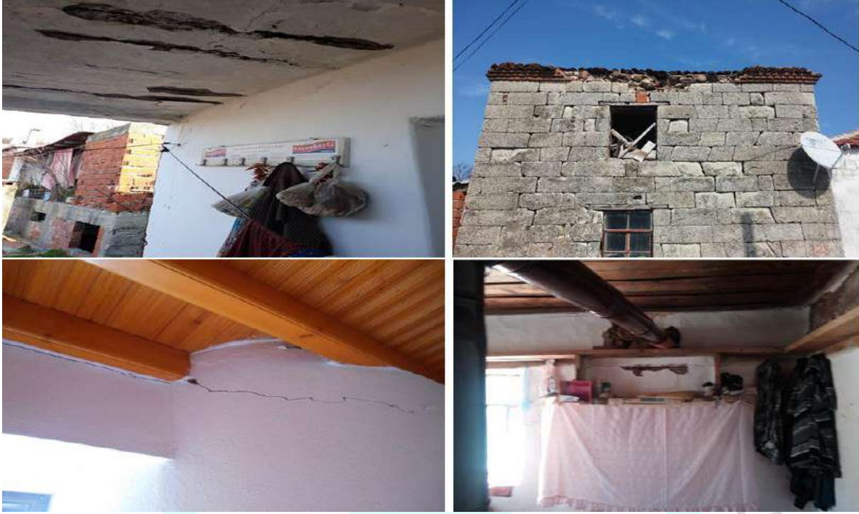
Şekil 7. Tavan döşemelerinde gözlemlenen hasarlar
