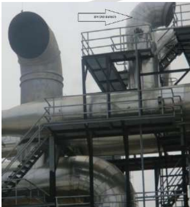
a. Dry end ve Wet end duct burner bacası
