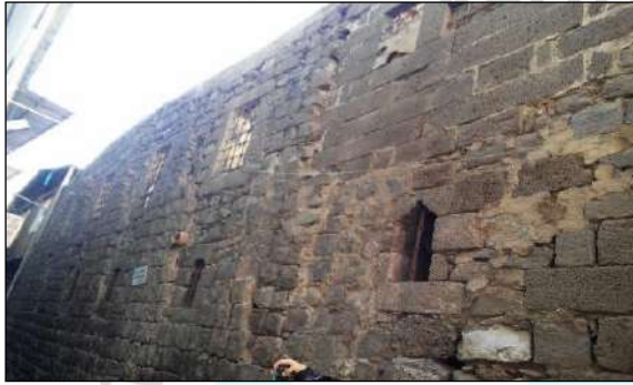
Şekil 18. Çifte Han Doğu Duvarındaki Eksen Kayma Hasarı
