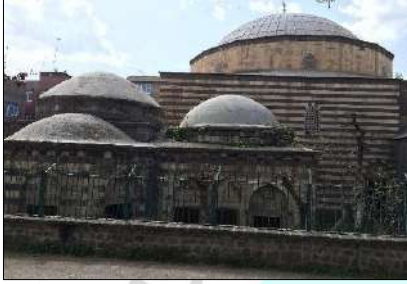
Şekil 10. İskender Paşa Camisinde Neme Bağlı Oluşan Sistem Hasarları
