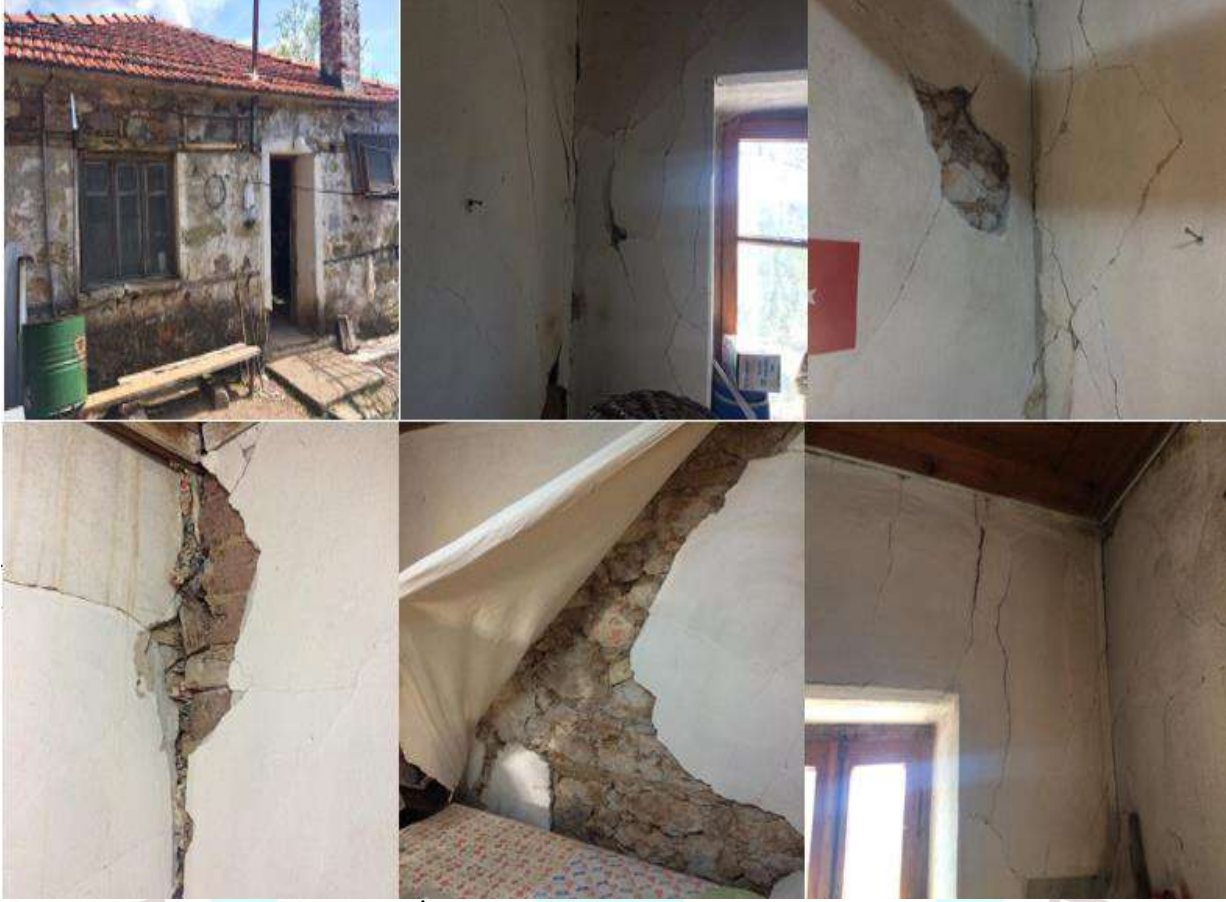
Şekil 4. İncelenen yapı ve yapıda oluşan hasarlar
