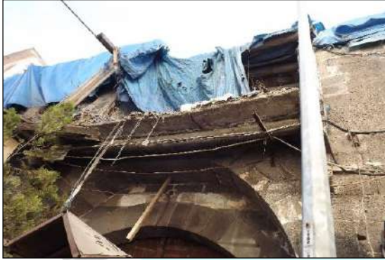
Şekil 27. Çifte Han Kuzey Cephesinde Doğa Koşulları ve Bakımsızlığa Bağlı Oluşan Hasar
