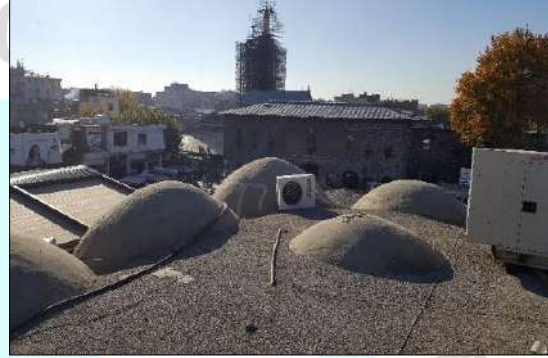
Şekil 24. Hasan Paşa Hanı'ndan Hatalı Restorasyonla Değiştirilen Üst Örtü Hasarı
