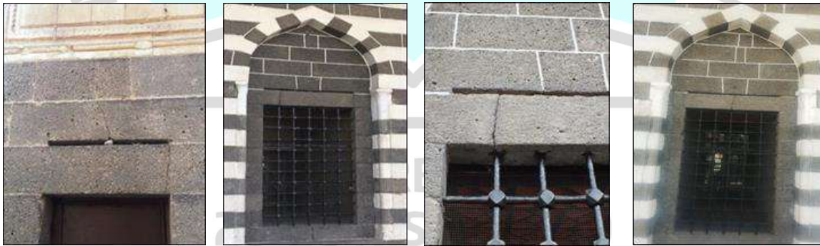
Şekil 4. İskender Paşa Cami Lentolarında Oluşan Çatlak Hasarları
