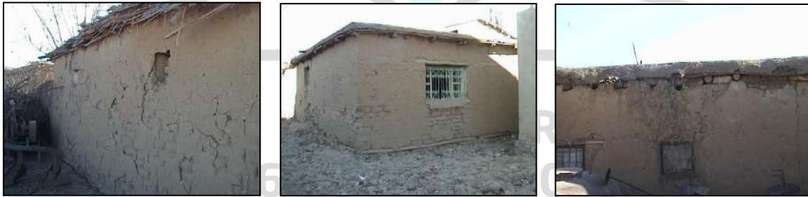
Şekil.2. Dış yüzey sıvalarında bozulma örnekleri
