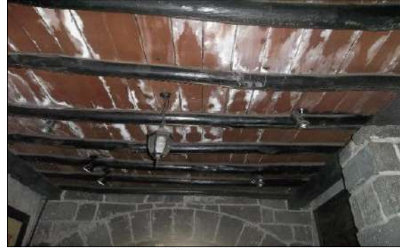
Şekil 26. Sülüklü Han'da Aşırı Yüke Bağlı Oluşan Sehimsizlik Hasarı
