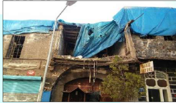
Şekil 19. Çifte Han Kuzey Duvarındaki Yıkılan Üst Örtüsü
