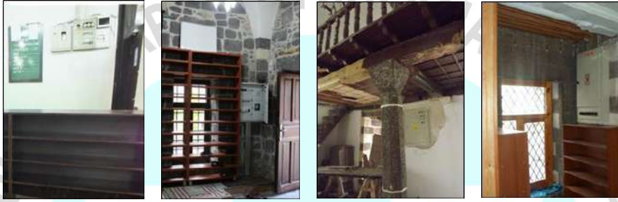
Şekil 14. Camilerde Restorasyon Sonrası Hatalı Tesisat Uygulamaları
