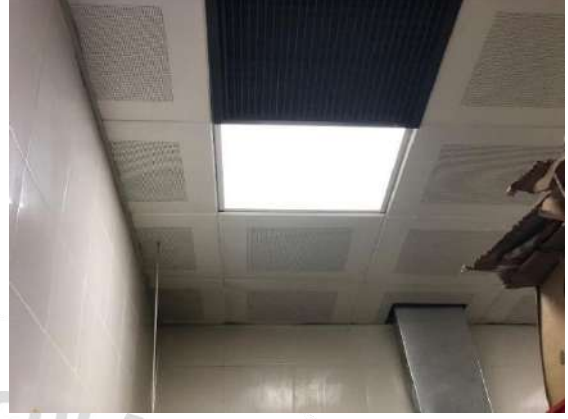
Fotoğraf 34: Mutfakta bulunan havalandırma sistemi
