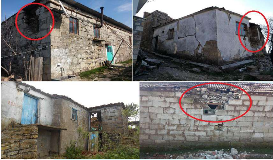
Şekil 3. Taşıyıcı duvarlarda meydana gelen hasar örnekleri
