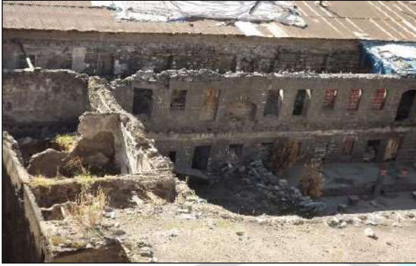
Şekil 15. Çifte Han'da Üst Örtüye Bağlı Oluşan Hasarlar 2019
