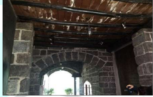
Şekil 16. Sülüklü Han'da Üst Örtüye Bağlı Oluşan Hasarlar 2019
