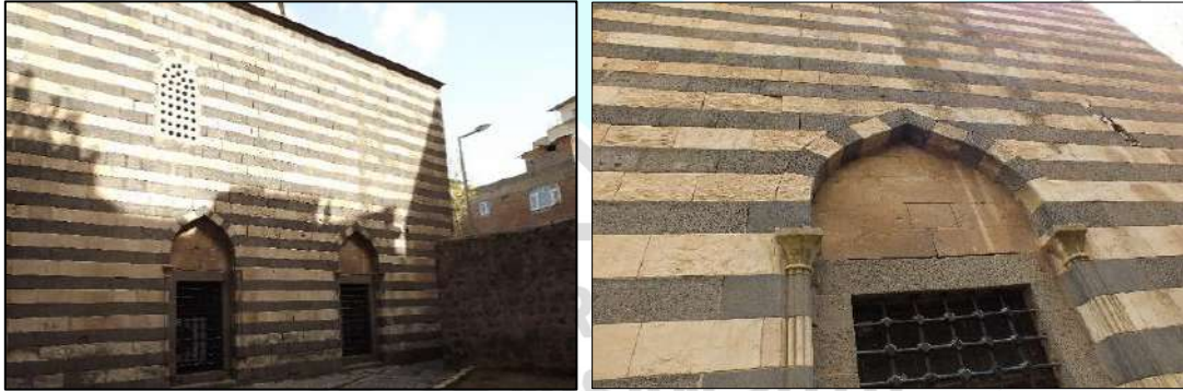
Şekil 2. İskender Paşa Camisi Batı Cephesinde Oluşan Duvarlardaki Ayrışma Hasarları
