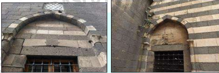
Şekil 8. İskender Paşa Camide derz boşalmalarına bağlı oluşan ayrışma hasarları
