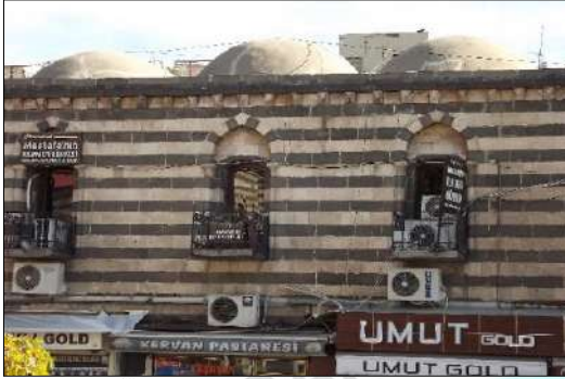
Şekil 11. Hasan Paşa Hanı Batı Cephesinde Ayrışma, Çözülme Hasarı 2019
