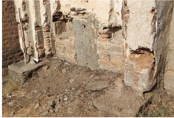
Görsel 5. Taş Malzemede Görülen Bozulmalar.
