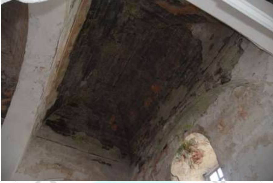
Görsel-17: Aynalı tonozun kaplamasında gözlemlenen dökülme (Bülent Ayberk ve Komd.Tug.K..ılığ Foto Film Merkezi – 2019)
